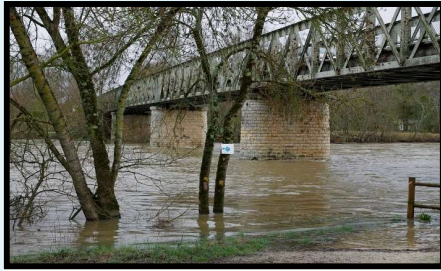
Multiplication des événements extrêmes : fortes pluies, inondations, sécheresses
